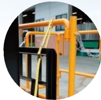
安全ロック (リフト上部)
