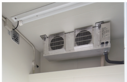
冷凍・冷蔵ユニット(内観)
