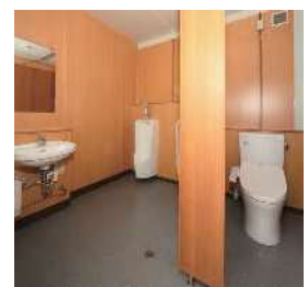
トイレコンテナ(内観)
