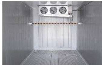
20フィート 冷凍冷蔵コンテナ内観
