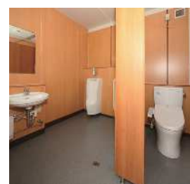
トイレコンテナ (内観)
